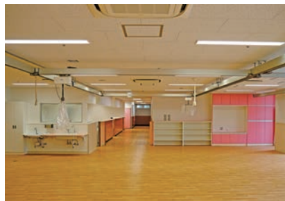
東1病棟 リフター
