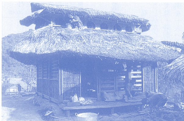
モン族独特の模様で土壁を飾ります 完成間近の文庫（図書館）
